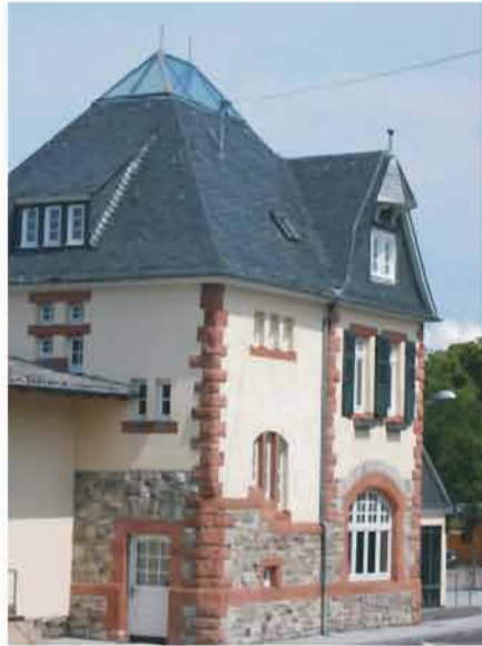
Qualitätsvolle Belichtung des Dachgeschosses ohne Veränderung der Dachform oder zusätzlichen Aufbauten: Dach und Gebäude bleiben weiterhin in ihrer historischen Form aufeinander bezogen
